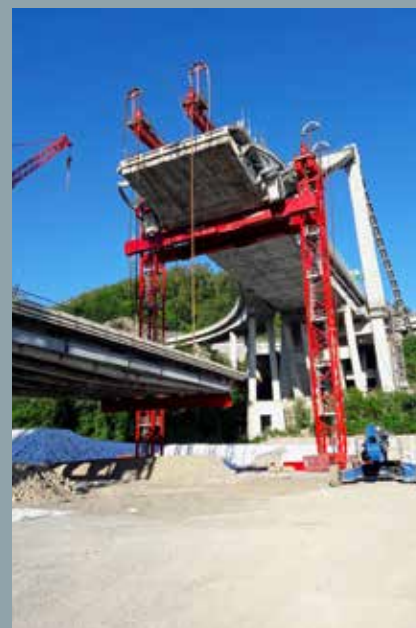
^ Figura 8: Abbassamento del tampone 11 compreso tra la pila 10 e 11
