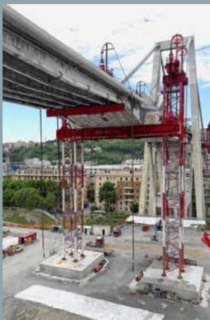
^ Figura 7: Messa in sicurezza della pila 10 e 11 mediante torri di supporto tralicciate
