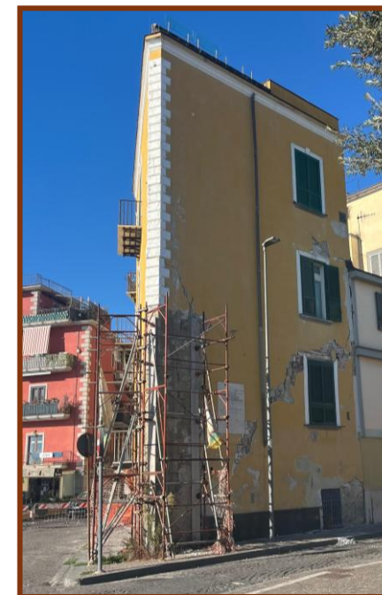
Danni strutturali ad un edificio
